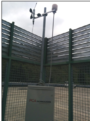
Fig. 1. Posizione della centralina di misura Pen3Meteo presso la porzione meridionale del tetto piano del complesso Rovercenter.
